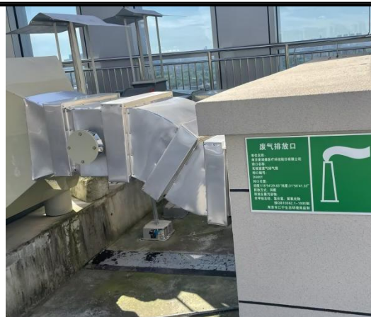
楼顶废气排气筒标志牌 DA001
