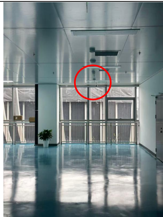
危废库外部监控
