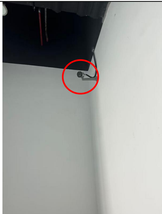
危废库内部监控
