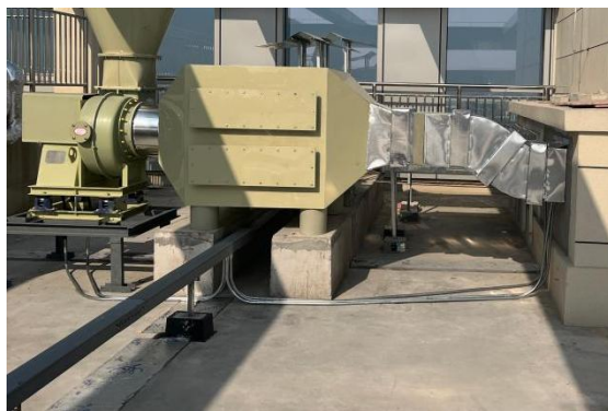
楼顶活性炭吸附装置
