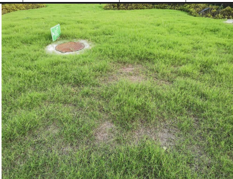
污水设施及排口
