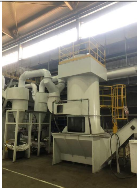
TA003 多级除尘装置
