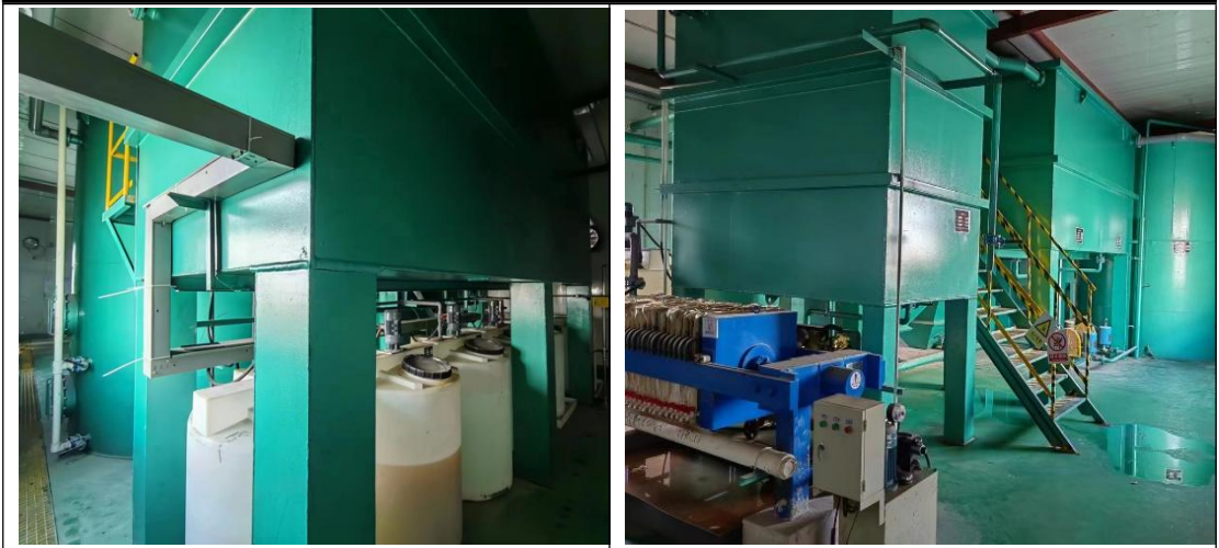
污水预处理设施
