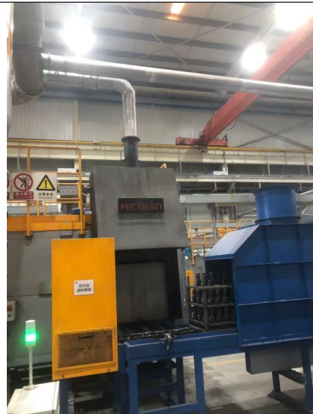
TA004 多级装置及排气筒
