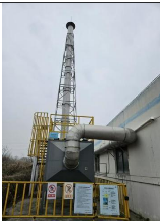
DA005 设备及排气筒
