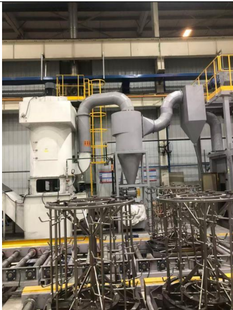
TA009 多级装置及排气筒
