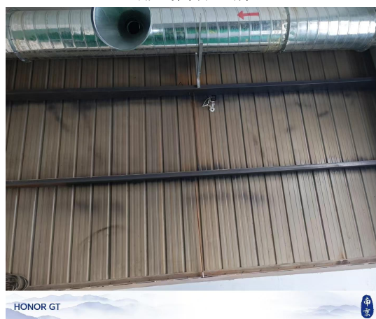
危废仓库（次生危废库）废气收集设施
