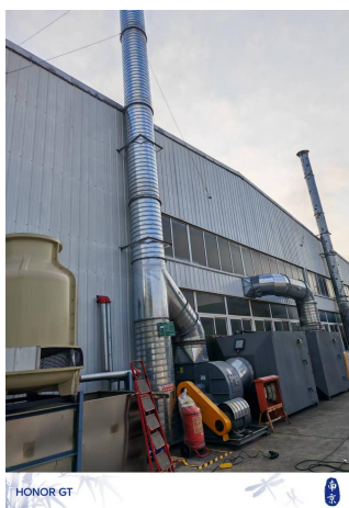
二级活性炭吸附设施及排气筒
