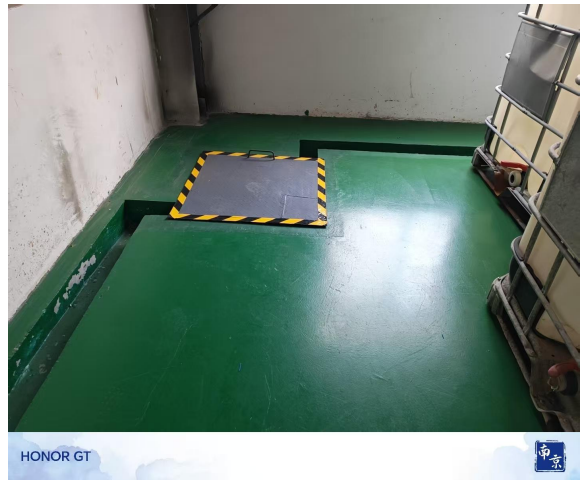
危废仓库（次生危废库）集液槽
