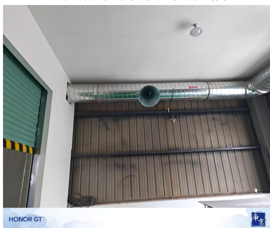
危废仓库（原料库）废气收集设施
