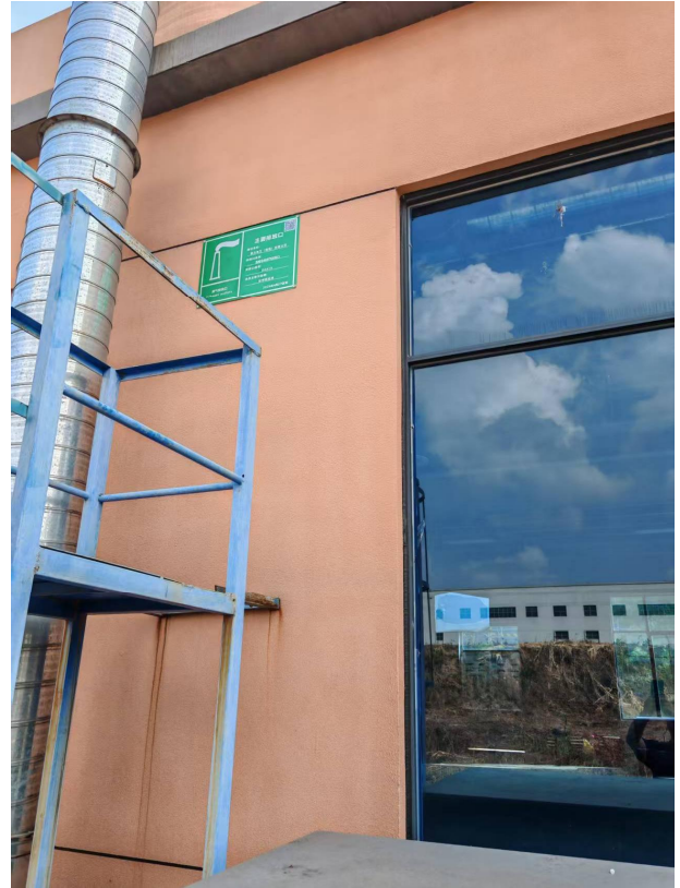
危废贮存废气排气筒标志牌
