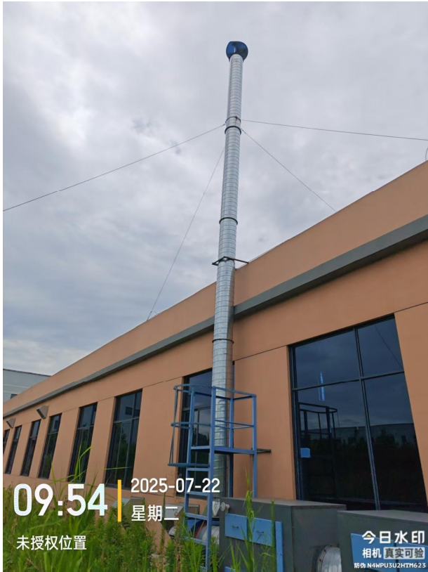
危废贮存废气排气筒照片
