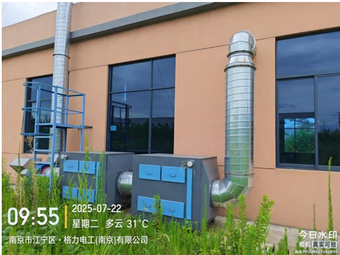
危废贮存废气处理设施照片
