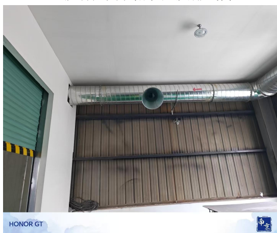
危废仓库（原料库）废气收集设施
