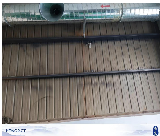
危废仓库（次生危废库）废气收集设施
