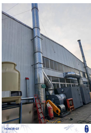
二级活性炭吸附设施及排气筒
