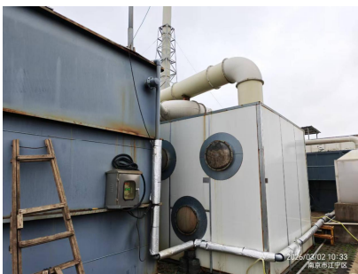
生物滤池除臭设施
