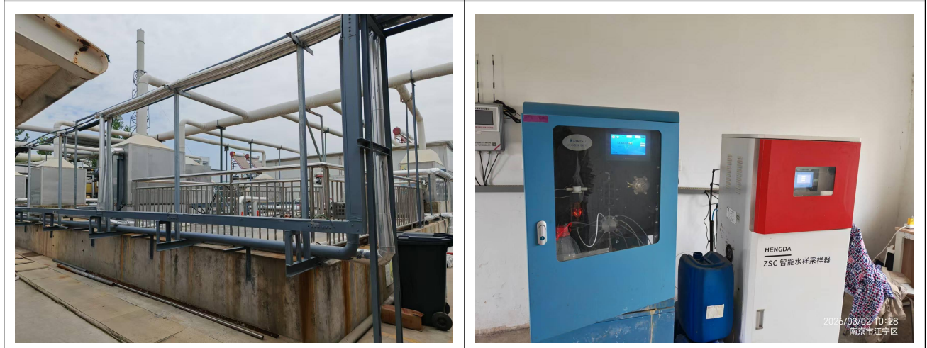
污水处理站照片
