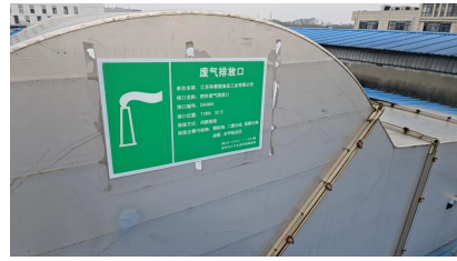
熬制废气排气筒 DA004
