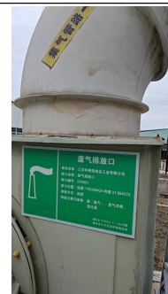
污水处理站废气排气筒 DA001
