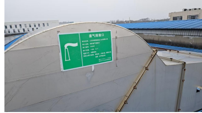
熬制废气排气筒 DA005
