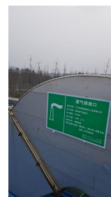
熬制废气排气筒 DA003
