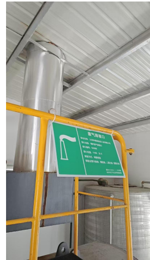
锅炉废气排气筒 DA006
