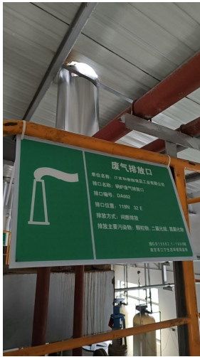
锅炉废气排气筒 DA002
