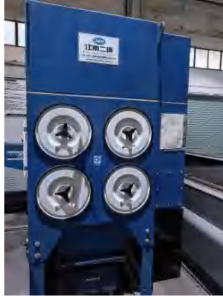
滤筒除尘装置
