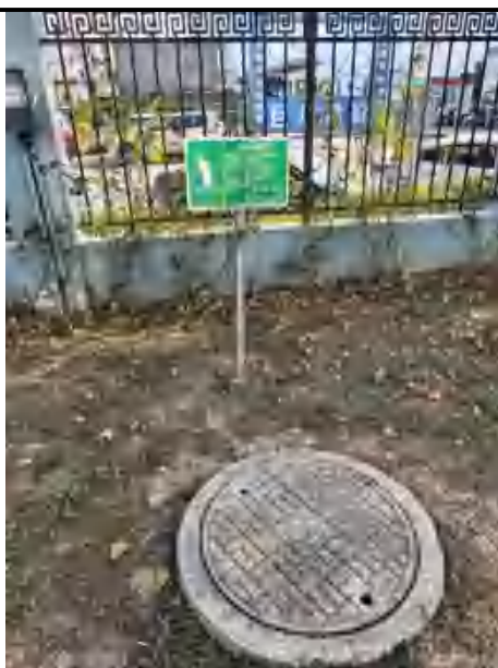
污水排放口标志牌
