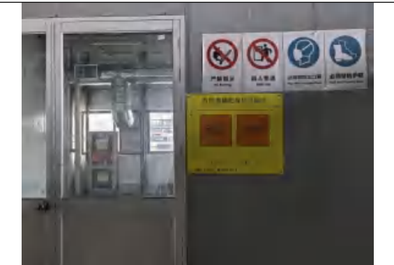
危废仓库内部分区标志牌
