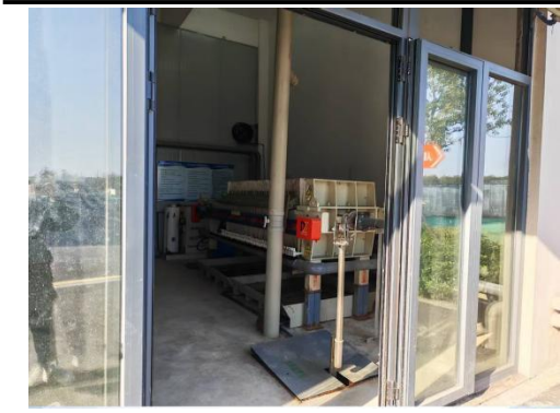
污泥压滤设施
