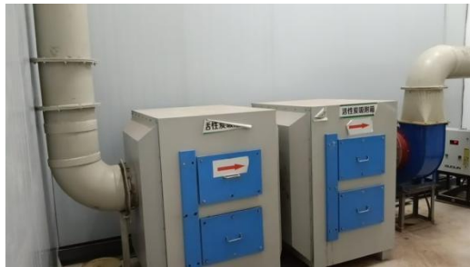
除雾器+二级活性炭吸附设施
