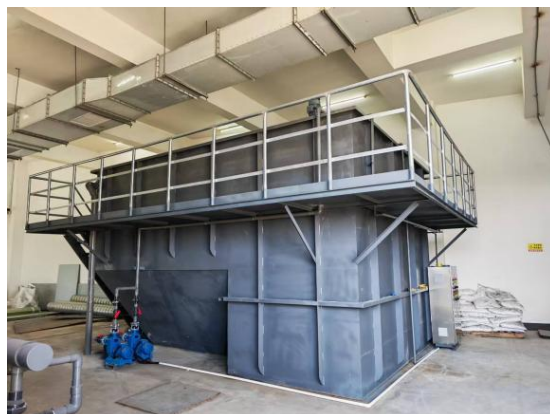
污水处理设施
