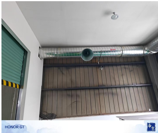
危废仓库（原料库）废气收集设施
