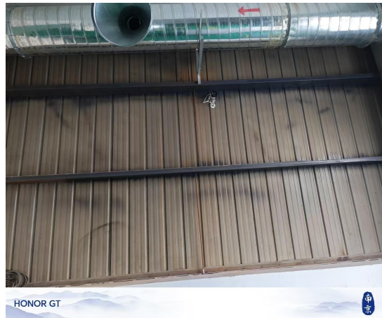
危废仓库（次生危废库）废气收集设施
