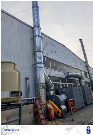
二级活性炭吸附设施及排气筒
