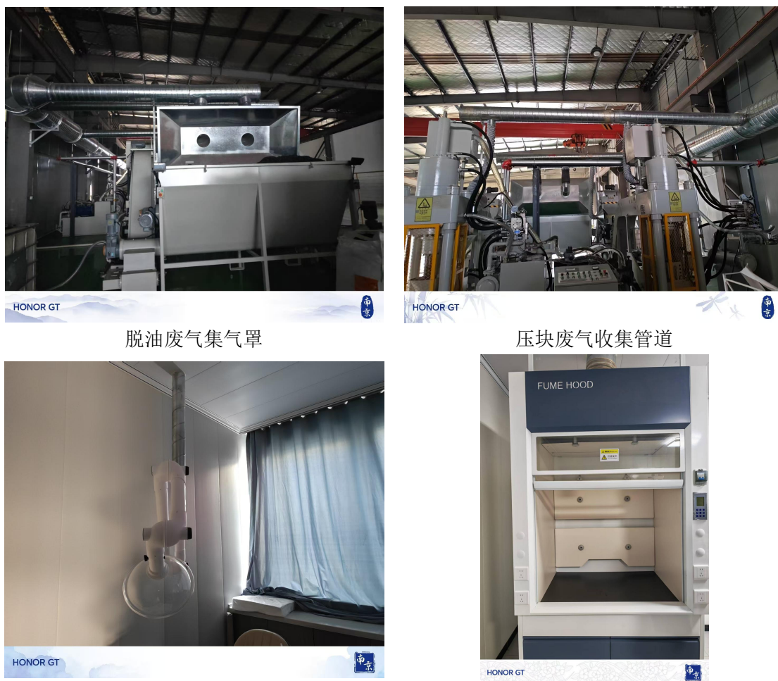
实验室集气罩及通风橱 图 4-3 验收项目废气处理设施及排放口照片
