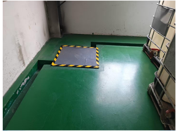
危废仓库（次生危废库）集液槽
