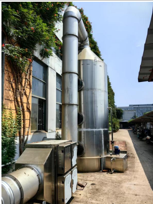
水喷淋+油雾净化装置
