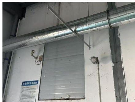
危废仓库监控设施
