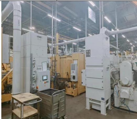
机加工油雾收集净化装置
