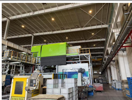
静电除尘系统
