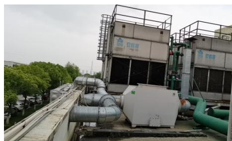
活性炭吸附装置（危废仓库）+DA007 排气筒
