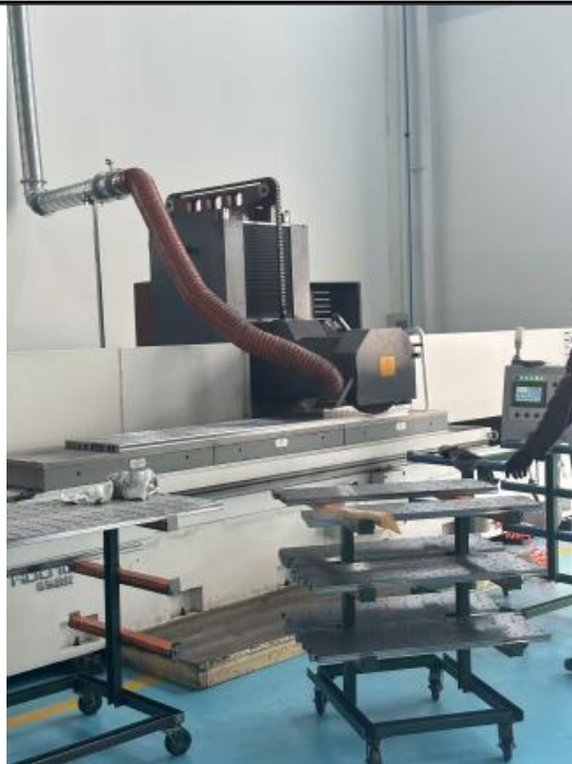
精修集气罩（收集后进入布袋除尘器）
