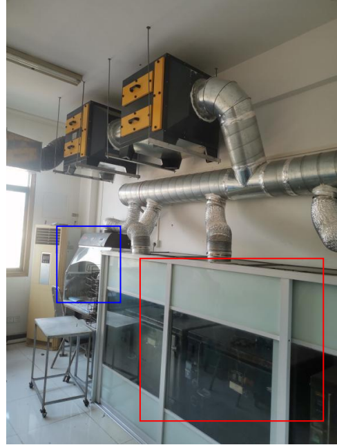
涂漆废气密闭集气罩收集、烘干废气密闭负压收集 TA003 二级活性炭吸附装置
