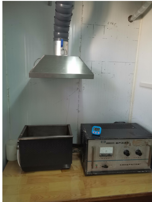
溶剂清洗废气密闭负压收集
