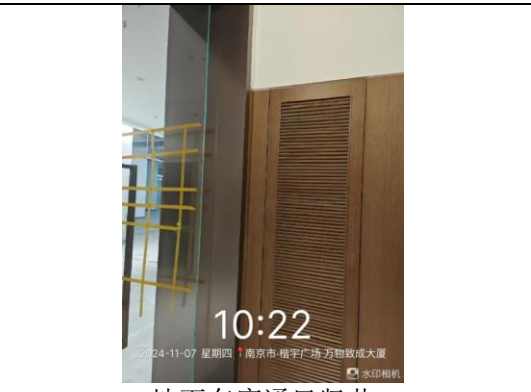
地下车库通风竖井
