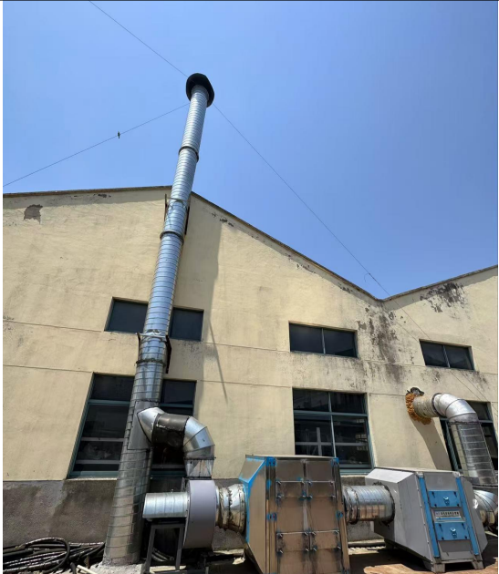
二级活性炭吸附装置 TA001+15m 排气筒 DA001
