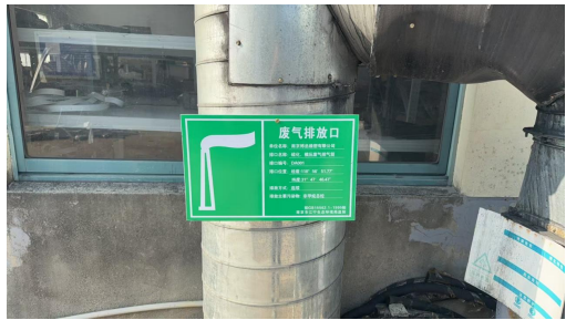
排气筒标志牌
