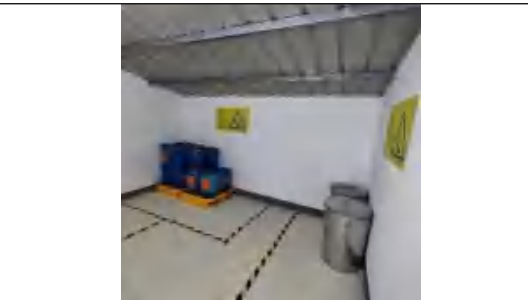
危废库防渗地面及防渗托盘
